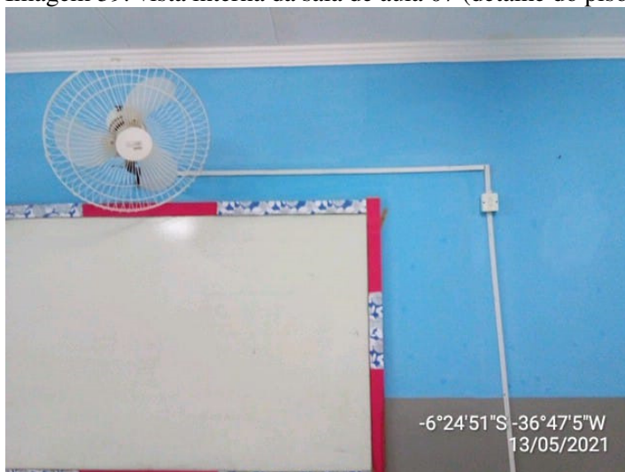
Imagem 40: vista da instalação elétrica de ventilador é externa.
