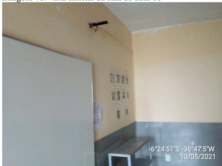
Imagem 42: vista da instalação elétrica de ventilador é externa.
