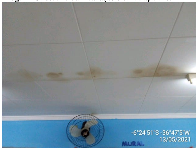
Imagem 16: Imagem de placas de gesso com umidade
