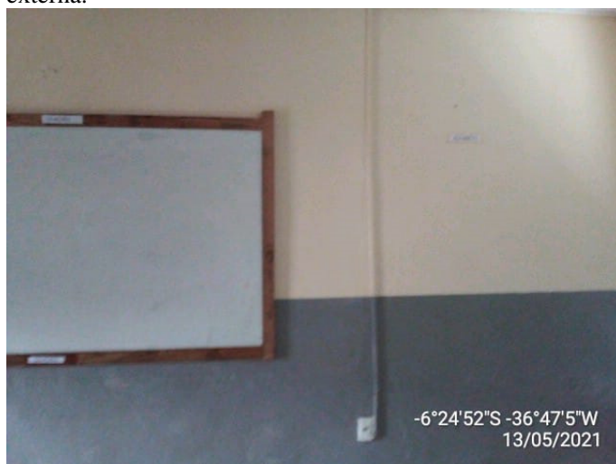
Imagem 17: detalhe da instalação elétrica aparente
