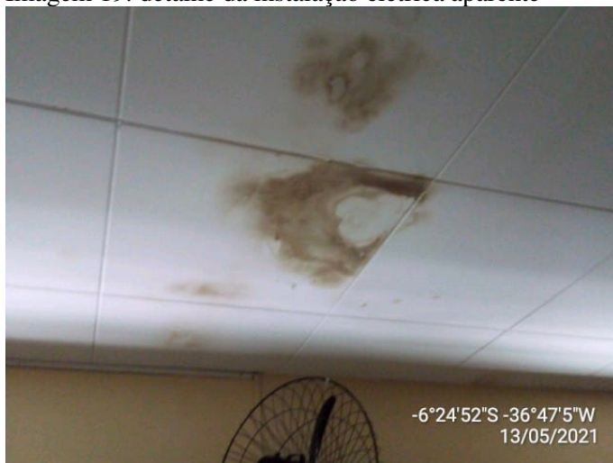
Imagem 20: Imagem de placas de gesso com umidade
