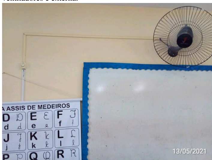
Imagem 09: instalação elétrica aparente
