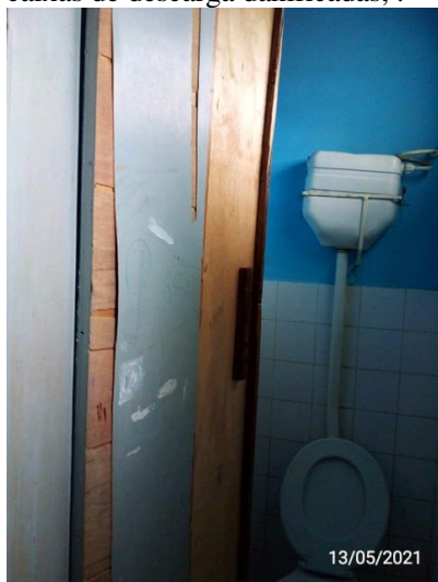
Imagem 31: vista interna do banheiro feminino (detalhe vaso sanitário e porta danificadas)
