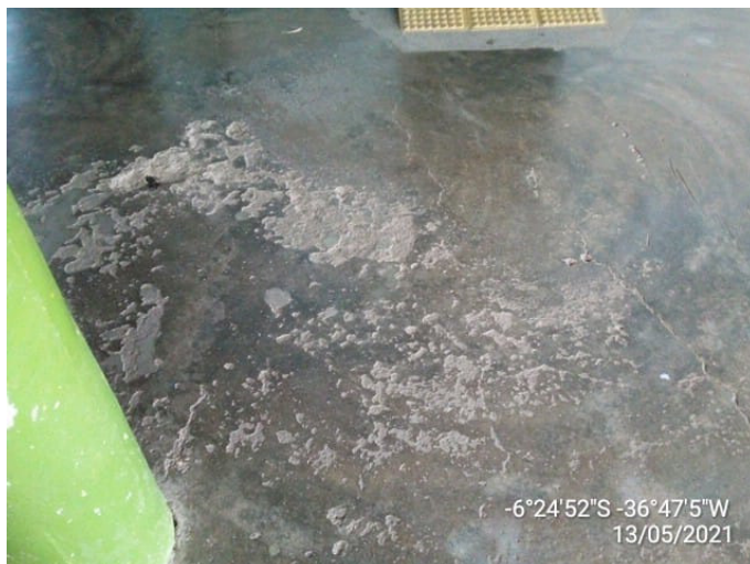
Imagem 23: vista do piso com fissuras
