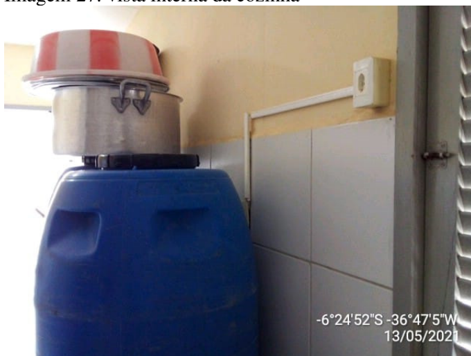
Imagem 28: vista interna da cozinha, em detalhe a tomada com calha externa
