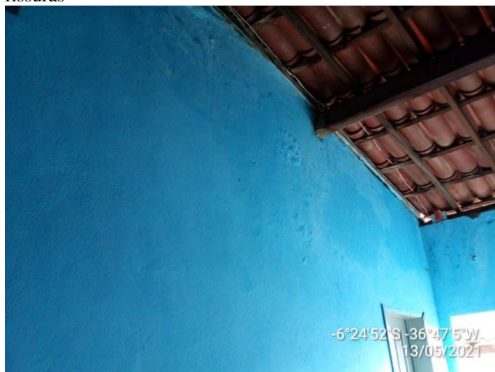
Imagem 33: vista externa do banheiro masculino (detalhe de umidade da caixa d'água)
