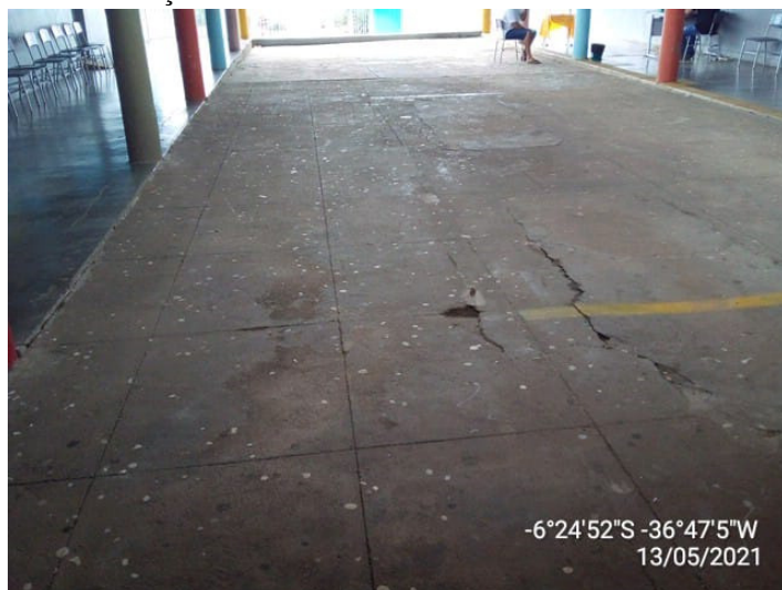
Imagem 21: vista do piso com fissuras
