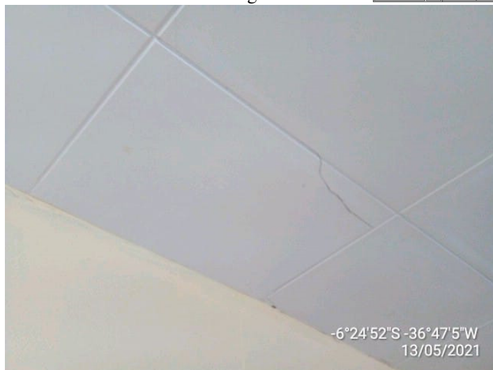
Imagem 35: vista interna (detalhe do forro trincado)
