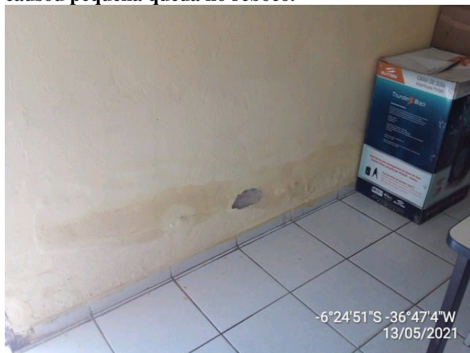
Imagem 01: detalhe de umidade no reboco
