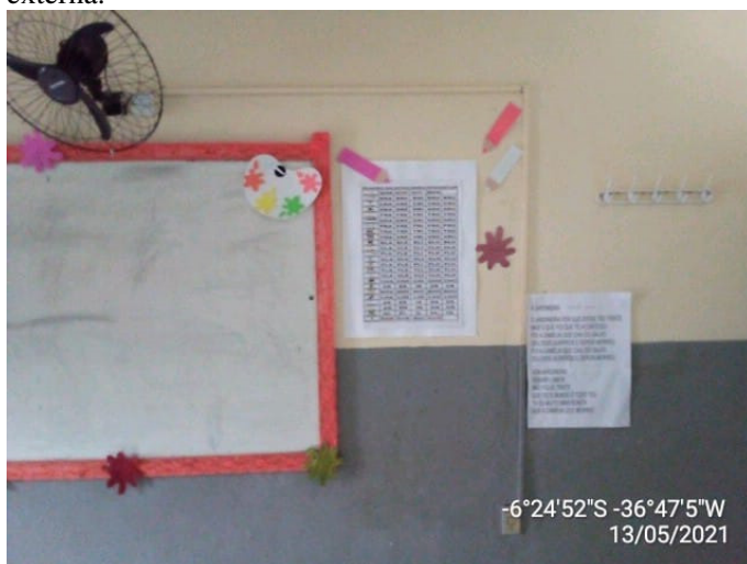
Imagem 19: detalhe da instalação elétrica aparente
