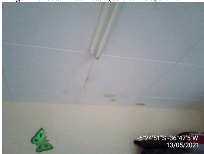
Imagem 18: Imagem de placas de gesso com umidade
