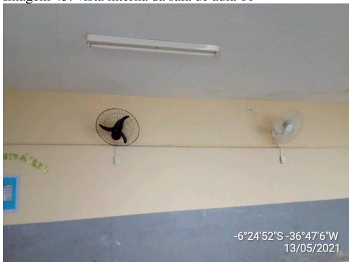
Imagem 46: vista da instalação elétrica de ventilador é externa.
