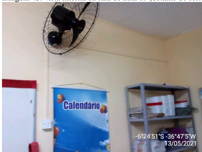
Imagem 44: vista da instalação elétrica de ventilador é externa.
