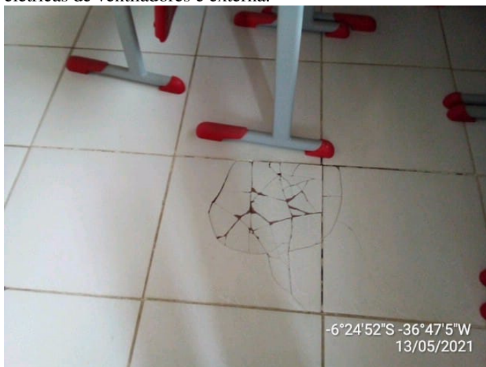
Imagem 39: vista interna da sala de aula 07 (detalhe do piso quebrado)
