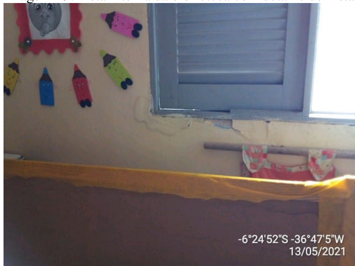
Imagem 30: vista interna da biblioteca com detalhe de umidade na parede
