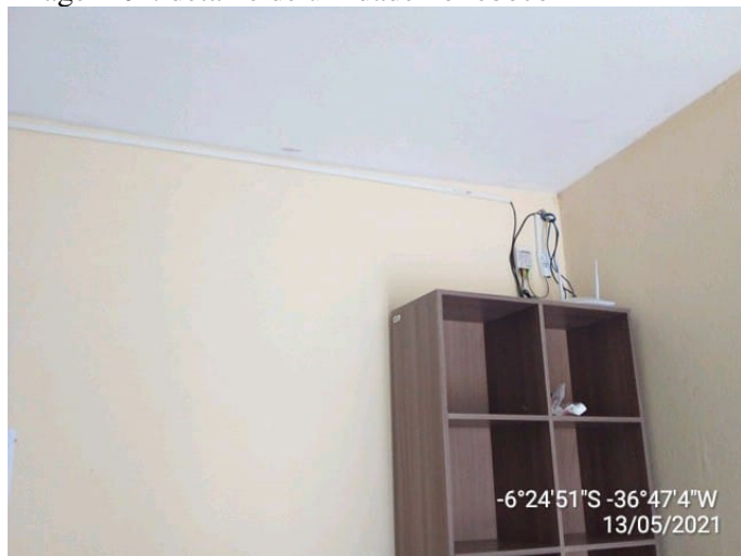
Imagem 02: detalhe de fiação por canaleta externa.
