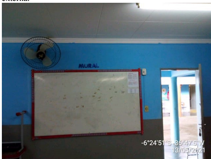
Imagem 15: detalhe da instalação elétrica aparente
