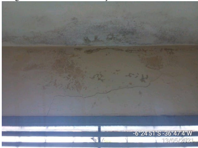
Imagem 06: detalhe de umidade de fissura no reboco.
