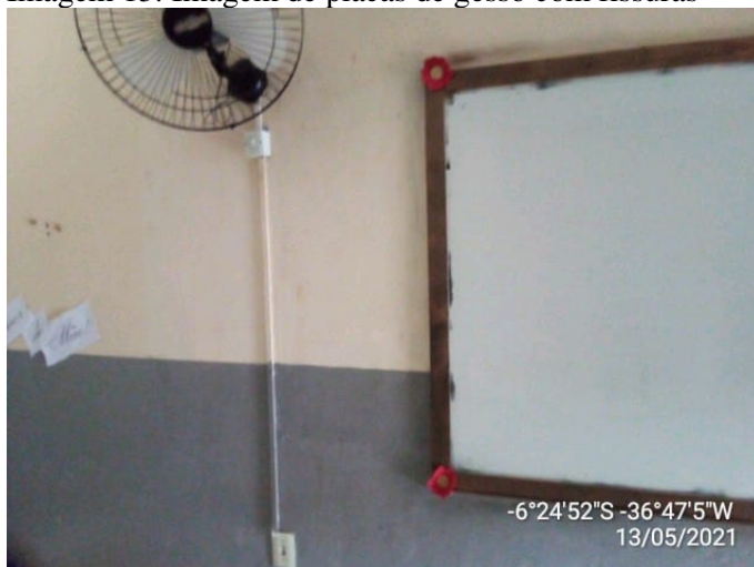
Imagem 14: detalhe da instalação elétrica aparente
